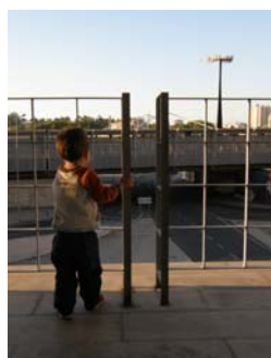
Fig. 3 – Guarda com elementos escaláveis e aberturas excessivas no preenchimento. Ed. Habitação 2007, SE APSI
