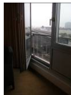
Fig. 5 – Caixilharia de janela com mecanismo de abertura a 1,3m. Espaço interior invadido com uma aresta cortante a 0,3m de altura, degrau de acesso à guarda. Hotel 2008, SE APSI
